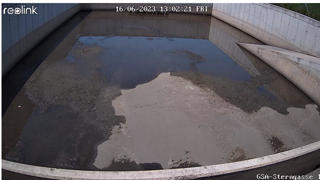
Abbildung 53: Absetzbecken am 16.06.2023, knapp sechs Tage nach dem letzten Niederschlag.
