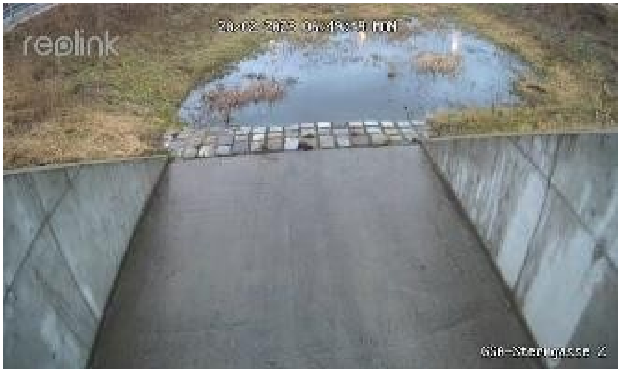
Abbildung 55: GSA Sternngasse, Bodenfilterbecken am 19.02.2023, beobachteter Einstau.
