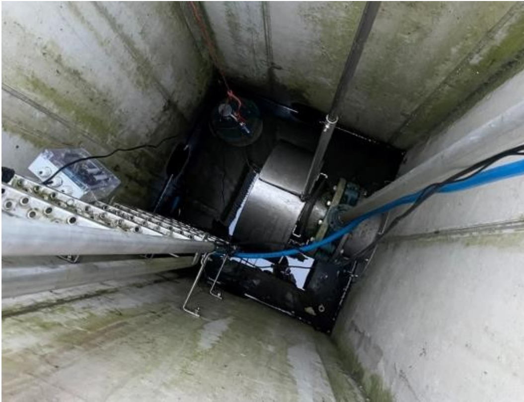
Abbildung 12: GPN im Sammelschacht vor der Anlage Gleisdorf West. (Quelle: B. Monai)
