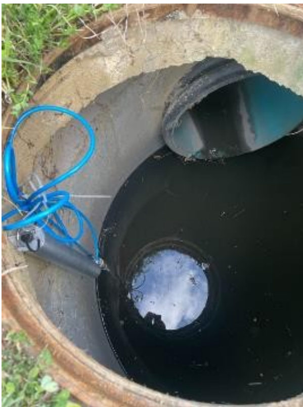
Abbildung 11: Positionierung Wasserstandsensor im Zulaufschacht vor der GSA Gleisdorf. (Quelle: B. Monai)
