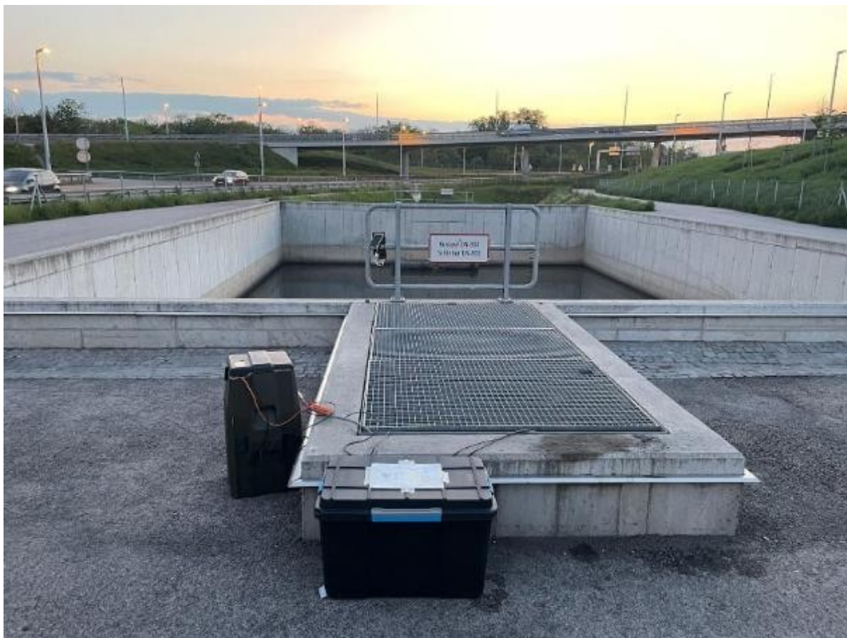
Abbildung 5: Zulauf Knoten Inzersdorf, GSA Sterngasse am 03.05.2023 (Quelle: B. Monai).
