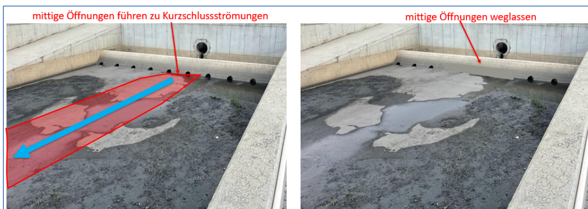
Abbildung 54: Ursache und vorgeschlagene Abhilfe für das Abschwemmen von Sedimenten im Absetzbecken der Gewässerschutzanlage Sterngasse.
